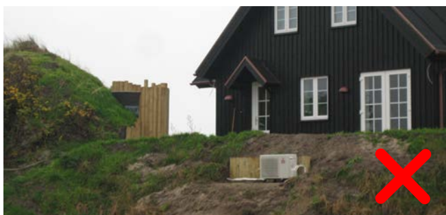
Varmepumpe ikke indbygget eller indpakket.
